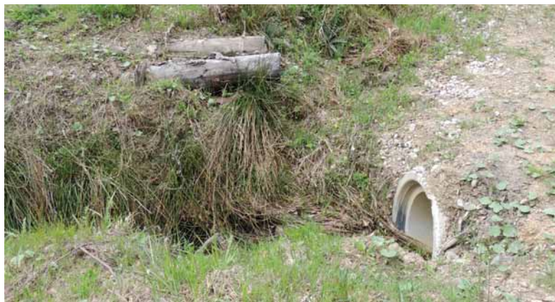
Obrázok 10 Prejazdy zväznic a menej využívaných ciest cez zamokrené miesta a drobné potôčiky je možné spevniť nekvalitnými kmeňmi vyťažených stromov a zakryť štrkom a zeminou. V prípade nutnosti sa dajú ľahko nahradiť betónovou rúrou. Príklad z lesnej správy Medzilaborce.
